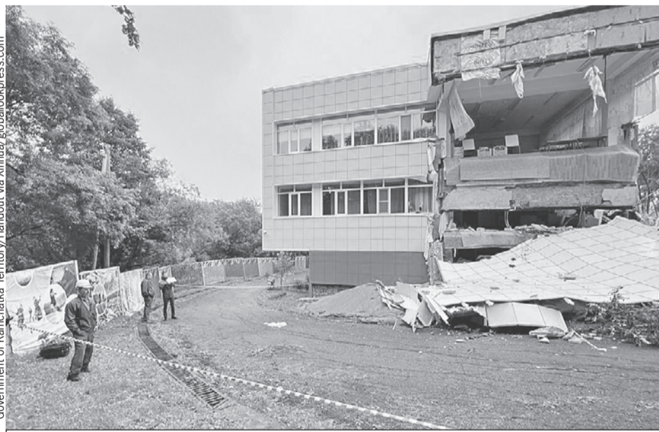
От подземных толчков обрушилась стена детского сада.
