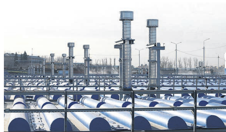
Модернизированные очистные сооружения правого берега.
