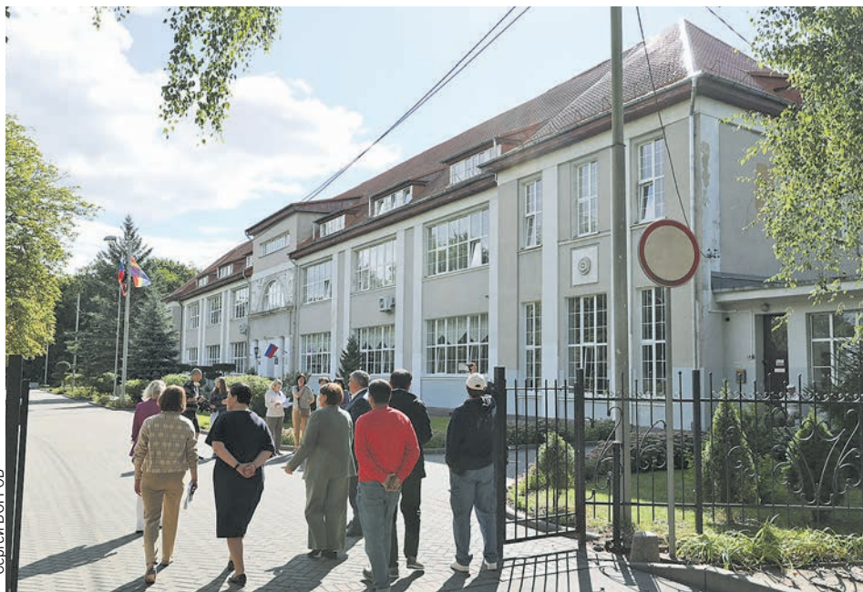
В здании, в котором когда-то учился Алексей Леонов, масштабные работы начнутся в следующем году.
